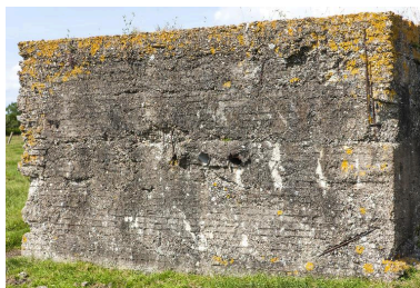
Elévation ouest. On remarque les empreintes de briques ainsi que 3 tuyaux traversant la paroi (destinés au passage de câbles ?) Phot. Jean-Marc Ramette IVR31_20145905362NUCA
