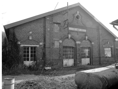
Pignon est de l'atelier de fabrication situé le plus au nord du site. Phot. Laurent Jumel IVR22_19966000036X
