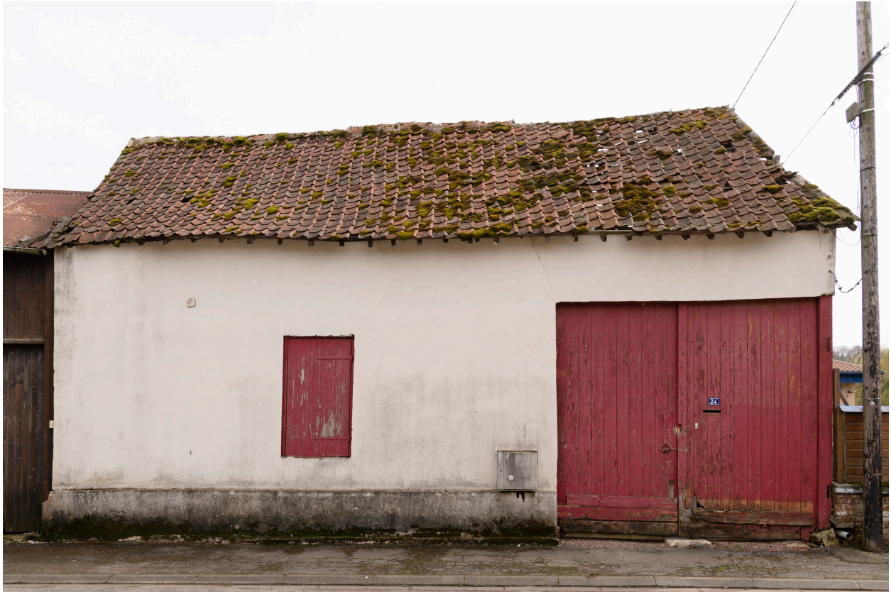
Grange sur rue, n°24 de la rue Poncelet, vue prise depuis le nord.
