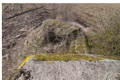
Depuis le couvrement, vue plongeante sur la soute à munitions (?) explosée Phot. Jean-Marc Ramette IVR31_20145904546NUCA
