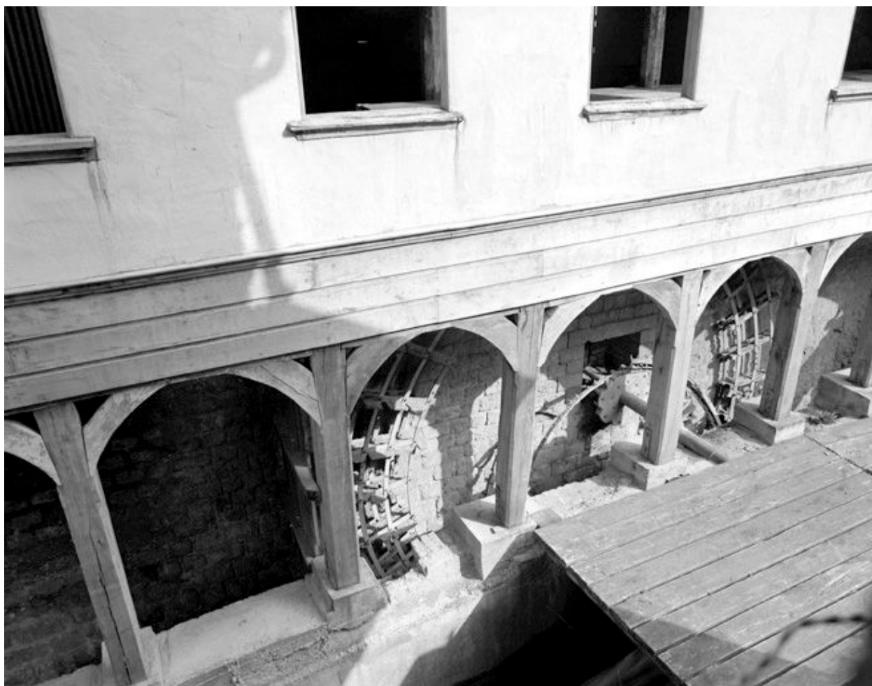
Coursier et roue hydraulique.
