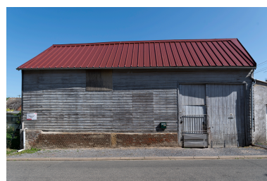
Grange avec entrée charretière, n°80 de la rue Casimir-Maumené, vue depuis le sud.
