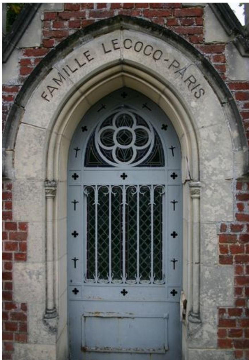
Détail de la porte en arc brisé, appareillée de pierre de taille.
