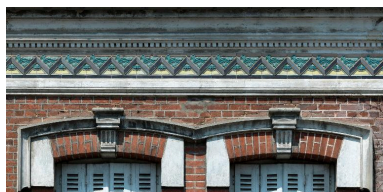
Détail des linteaux de fenêtres et de la frise en céramique architecturale. Phot. Thierry Lefébure IVR22_20138000200NUC2A
