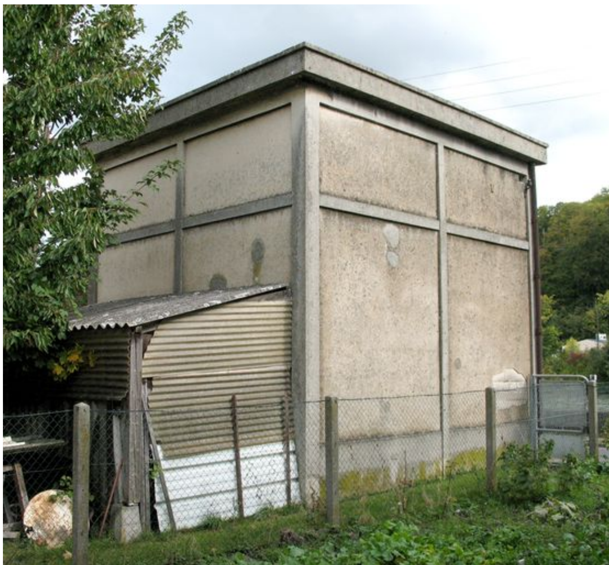
Le transformateur électrique vu vers l'Oise.
