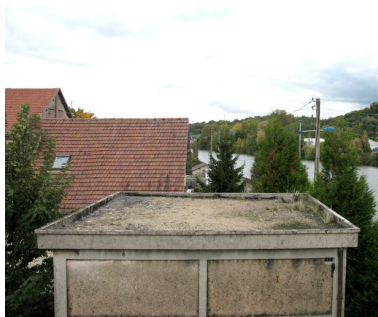
Toit terrasse du transformateur. Phot. Clarisse Lorieux IVR22_20096005176NUCA
