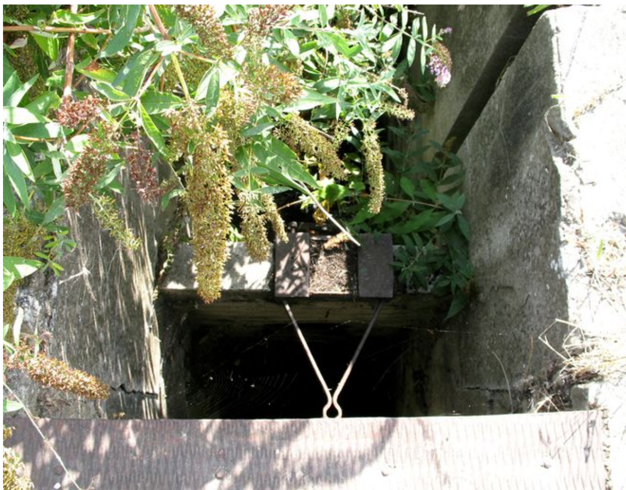
Prise d'eau dans l'Oise.
