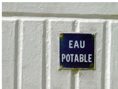
Détail de la plaque émaillée mentionnant : eau potable. Phot. Elisabeth Justome IVR22_20058002807NUCA
