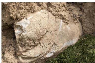
Sac de ciment, à la base de l'édifice. Utilisé couramment pour renforcer ou protéger une position Phot. Jean-Marc Ramette IVR31_20145905387NUCA
