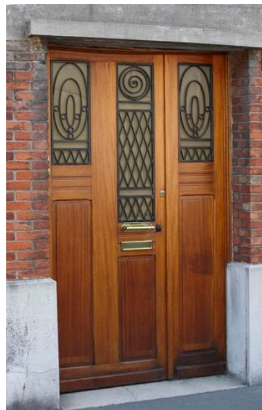
Détail de la porte aux motifs à spirales. Phot. Pierre Thibaut IVR31_20096200175NUCA
