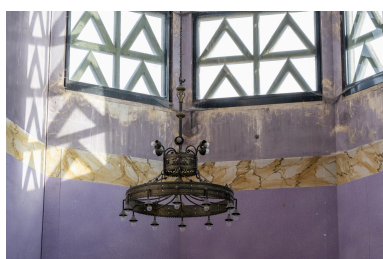
Vue du luminaire du chœur. Phot. Pierre Thibaut IVR32_20258002305NUCA
