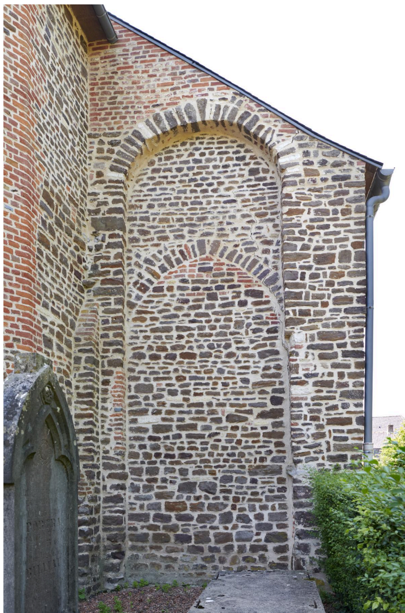
Détail d'une baie rebouchée au niveau du bas-côté nord (à l'arrière de l'édifice).
