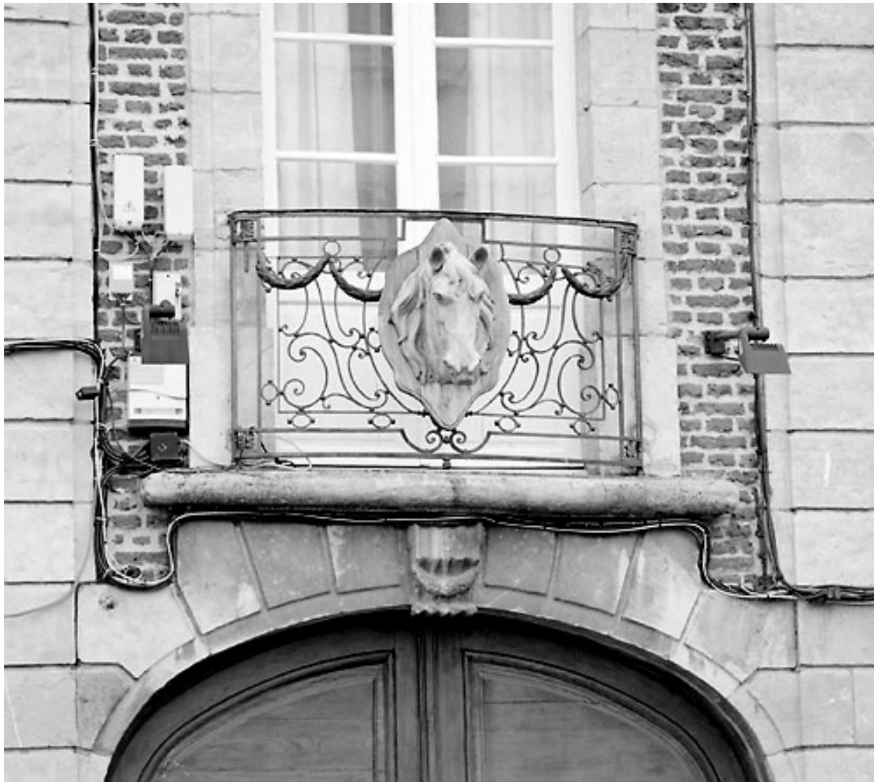
Étage, travée de passage cocher, détail : balcon (la tête de cheval est un ajout des années 2000).
