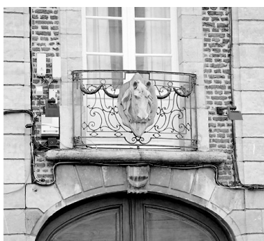
Étage, travée de passage cocher, détail : balcon (la tête de cheval est un ajout des années 2000).
