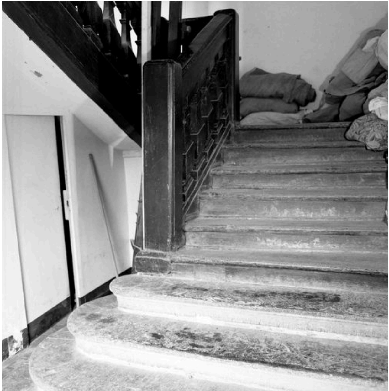
Aile de la rue de la Cavalerie : n° 35-37, escalier "de Louis XIV" desservant actuellement le 1er étage du corps de logis médiéval : rez-de-chaussée, 1ère volée.
