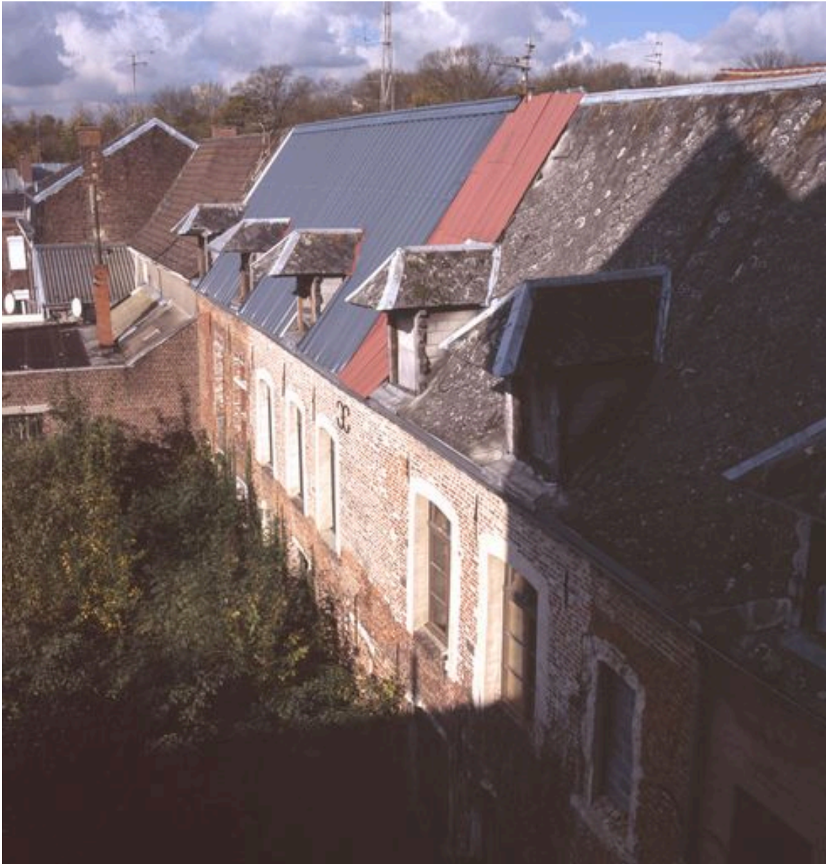
Aile de la rue de la Bibliothèque : vue depuis la grande salle (2e étage) du corps de logis médiéval.
