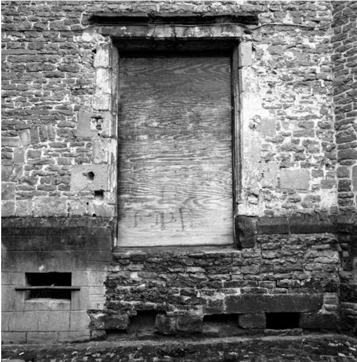
Corps de logis médiéval, façade arrière, rez-de-chaussée, vue partielle : baie occultée et accès condamné à la cave.
