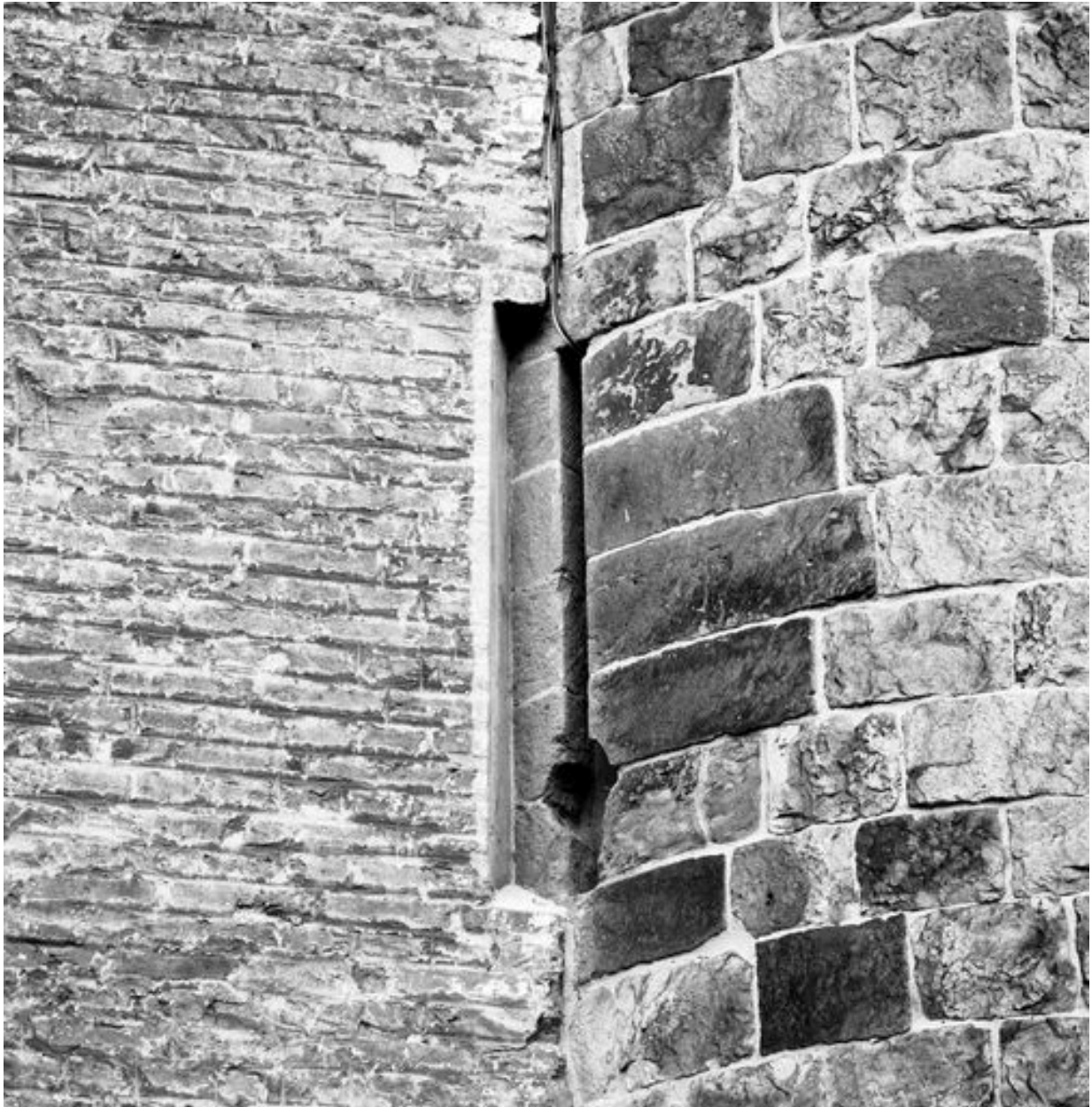
Corps de logis médiéval, façade, liaison avec l'aile n° 35-37 rue de la Bibliothèque, détail : tourelle sud, meurtrière.
