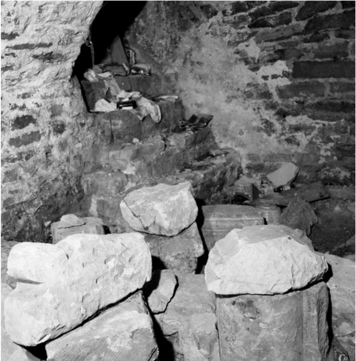
Corps de logis médiéval, intérieur, cave, escalier d'accès d'origine (fermé), donnant sur la façade arrière.
