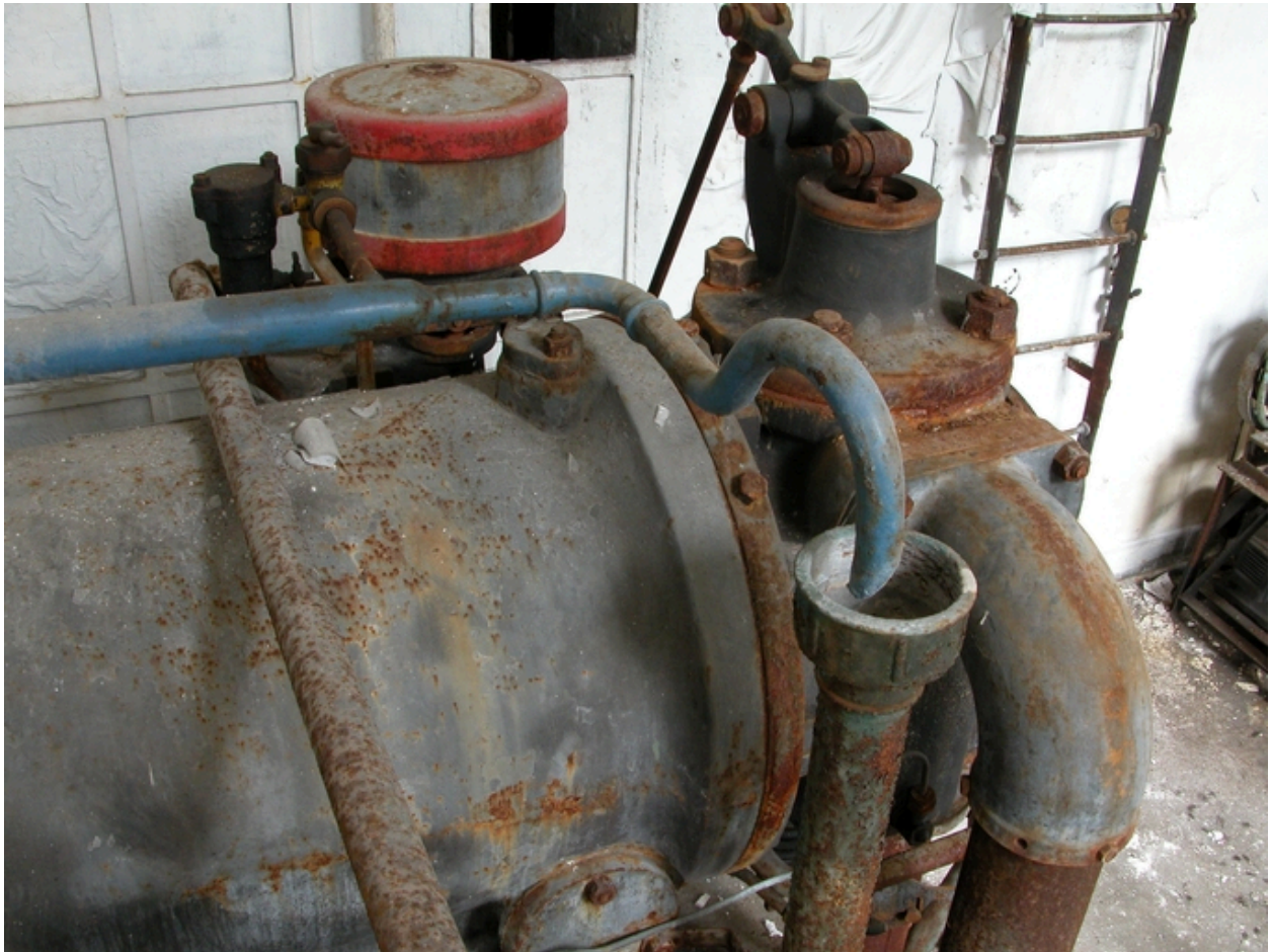
Régulateur, système d'admission et échappement des gaz de l'un des deux moteurs.
