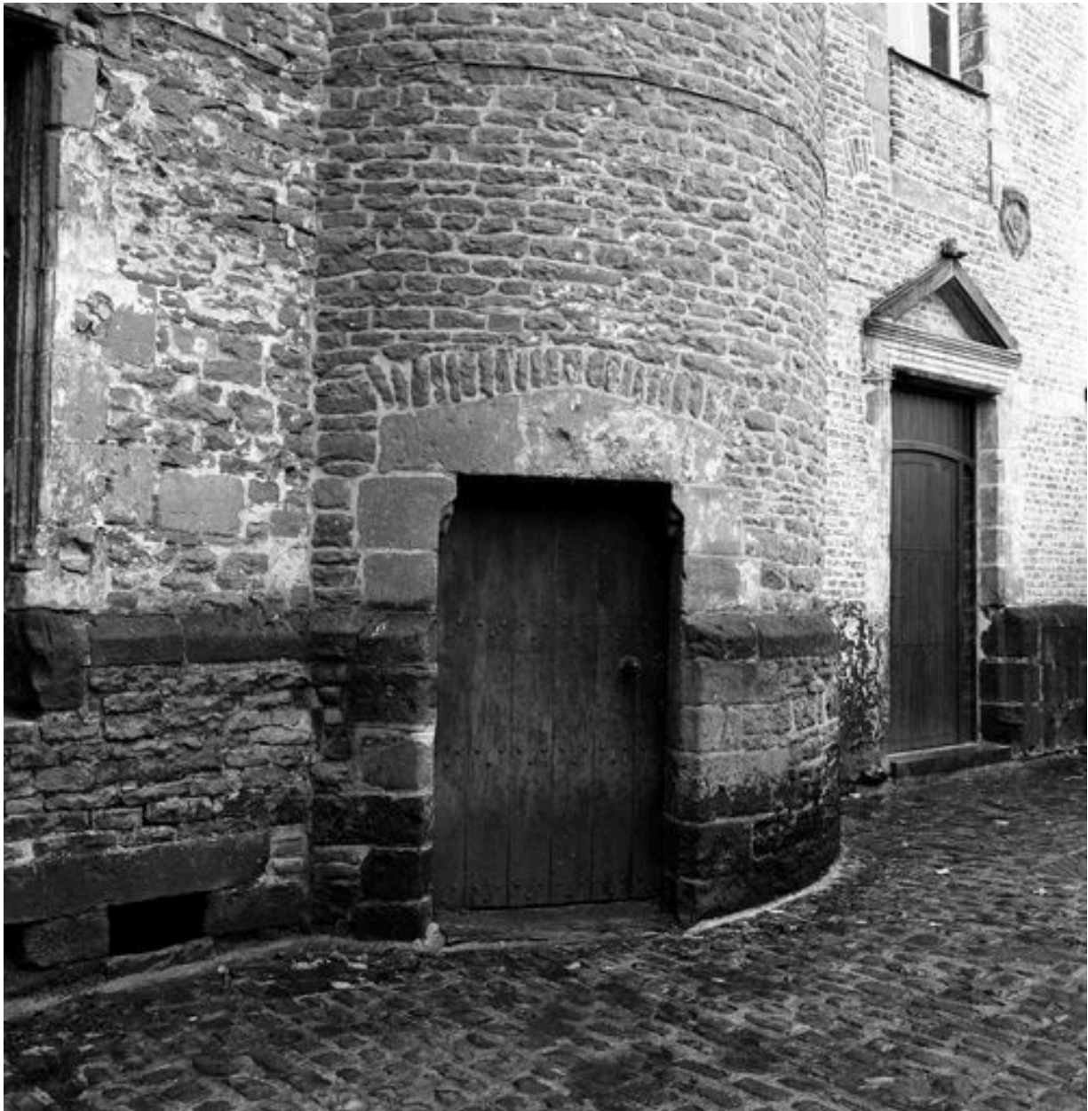
Corps de logis médiéval, façade arrière, tourelle d'escalier (ouest), vue partielle : rez-de-chaussée, porte couverte par un linteau en bâtière reposant sur des coussinets.
