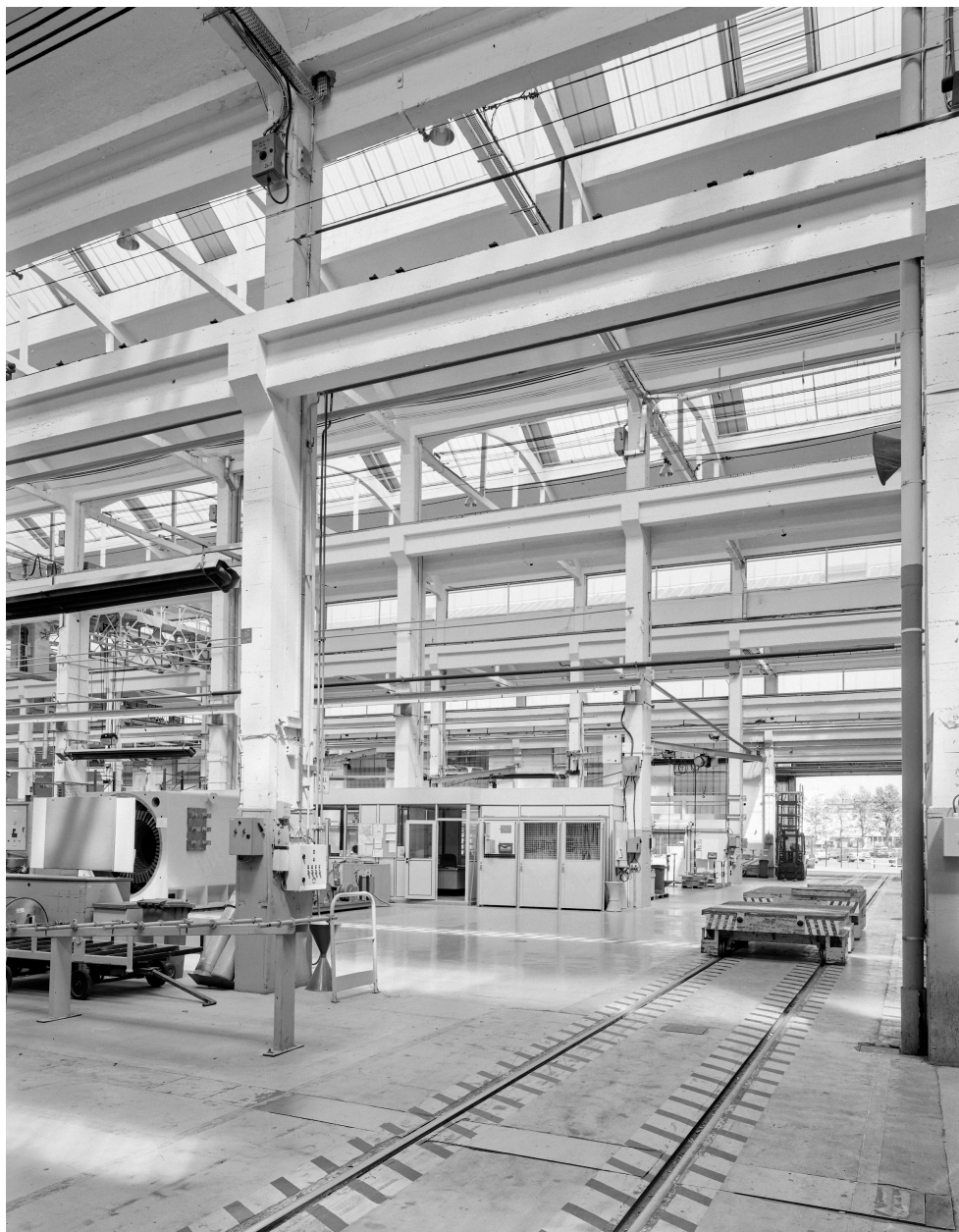
Vue générale intérieure de la structure en béton des halles 20 à 23 nord.
