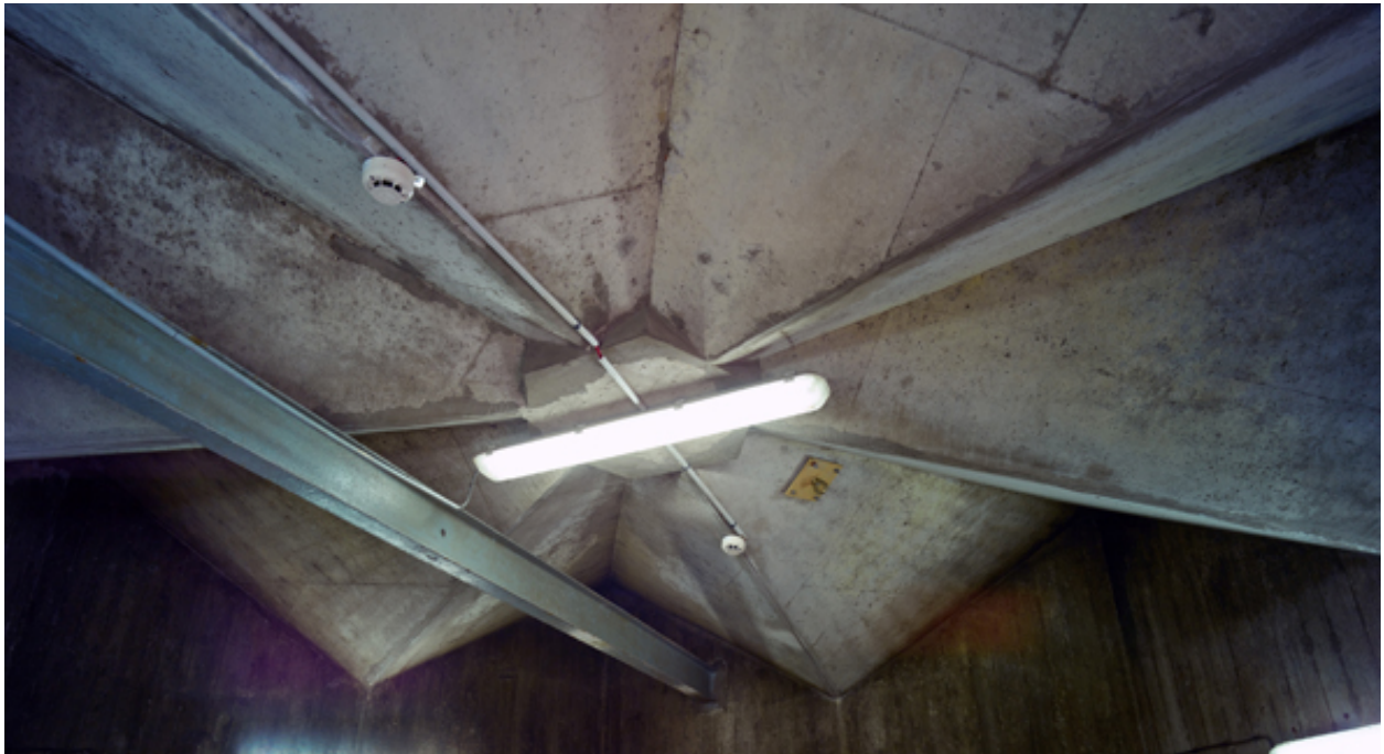
Vue de la sous-face de la toiture du local à machine de l'ascenseur de la tour de l'internat.
