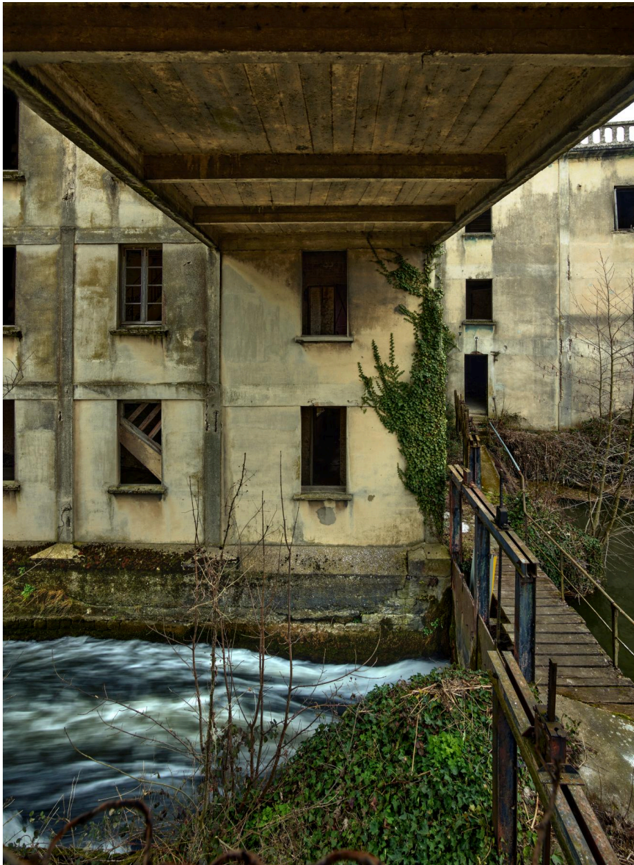
Détail de la coulerie et du tablier de la passerelle reliant les deux parties de la minoterie.
