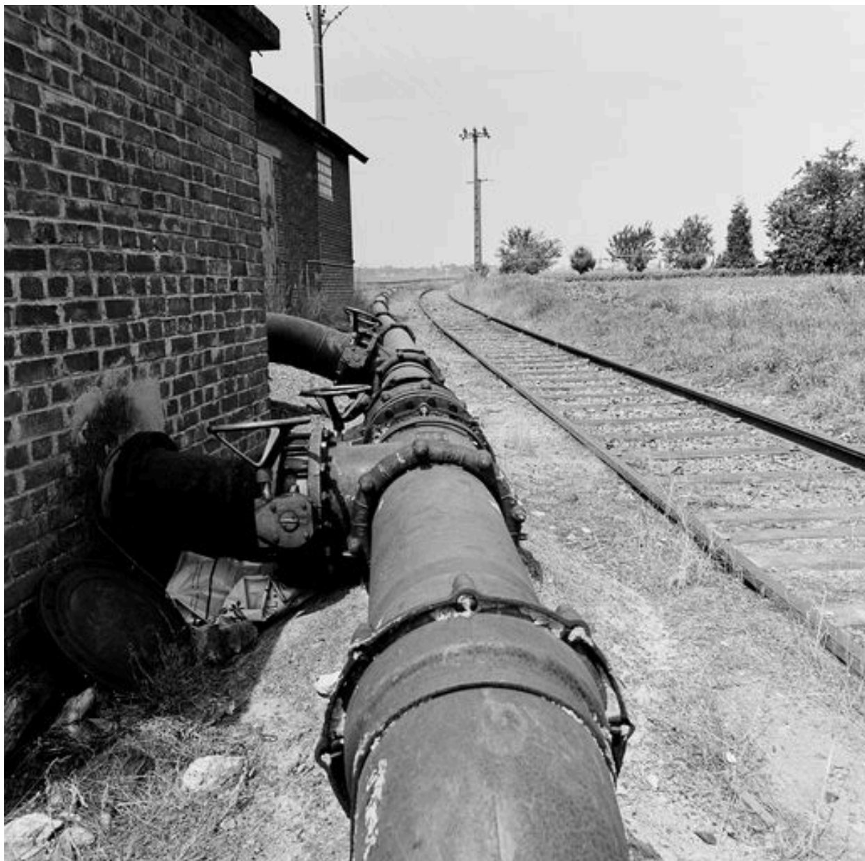
Station de pompage, canalisation vers l'usine.
