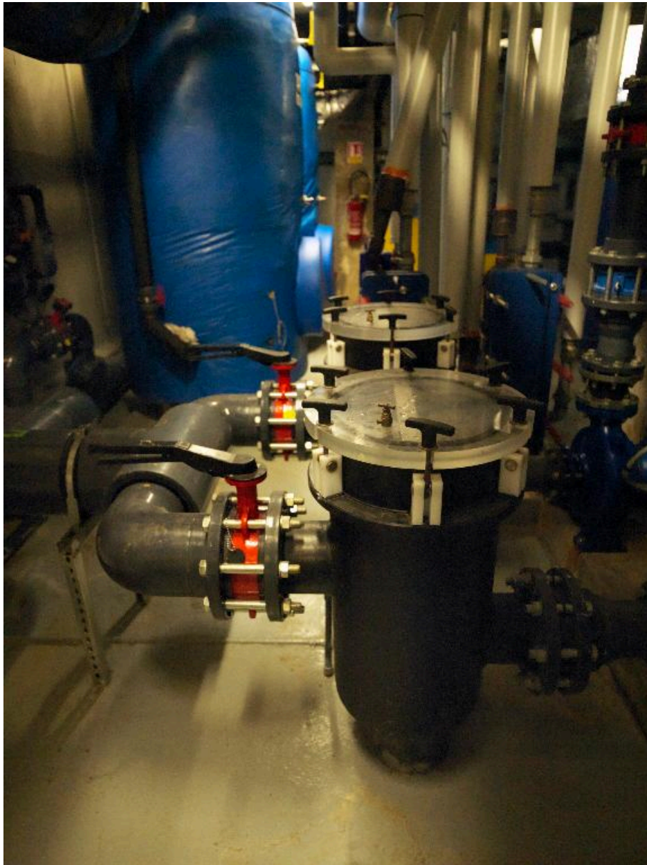
Détail du système renouvellement de l'eau : les filtres.
