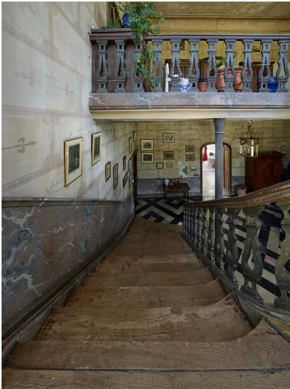
Vue plongeante de la dernière volée de l'escalier à double volée du vestibule et balustrade de l'étage.
