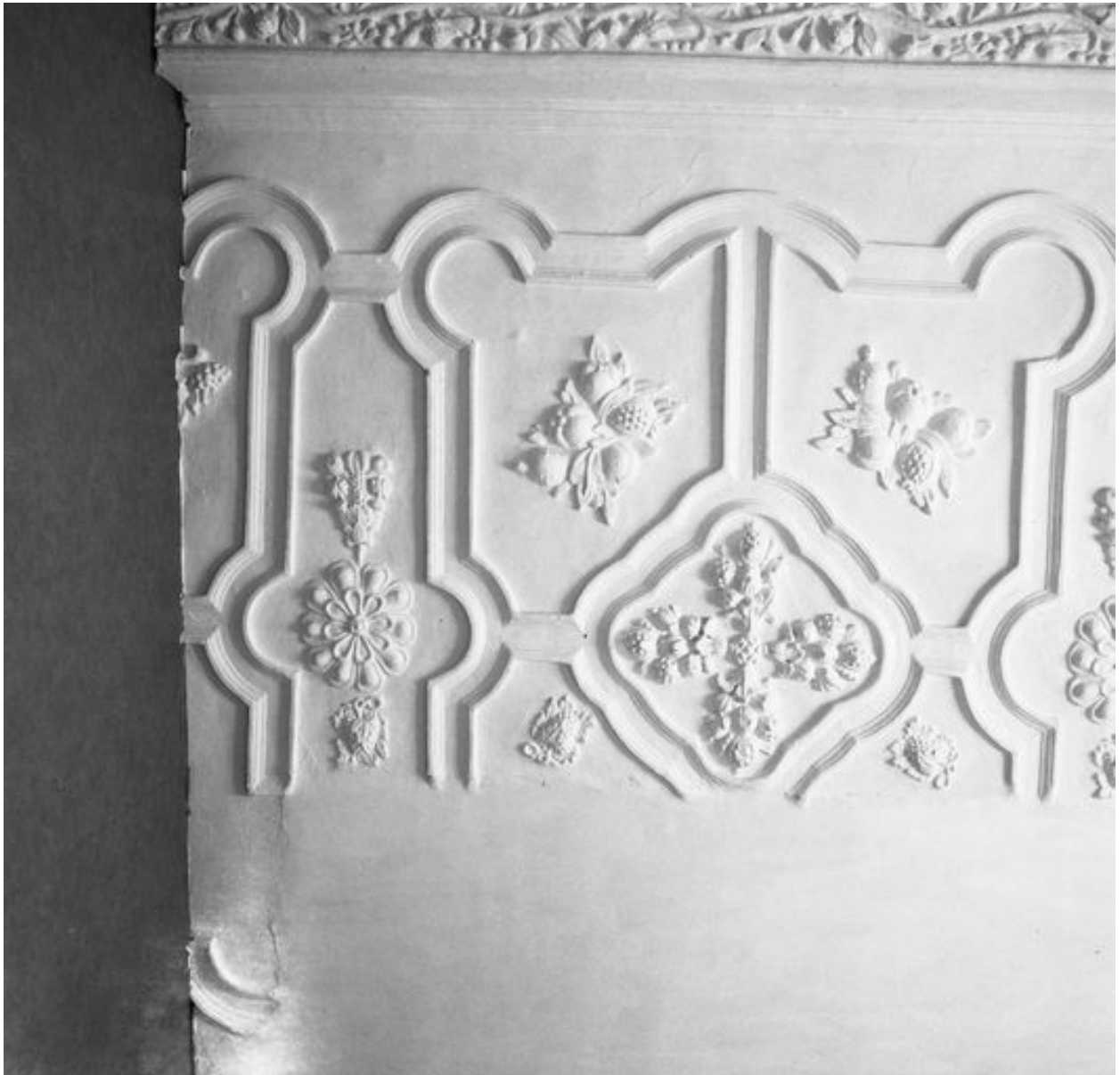
Vue partielle du plafond coupé par le cloisonnement en logements (ici, n° 37 rue de la Cavalerie).
