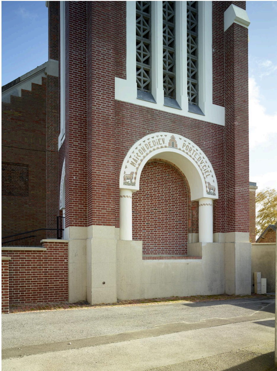
Vue de détail des deux premiers niveaux du clocher-porche côté ouest avec les claustras en béton.
