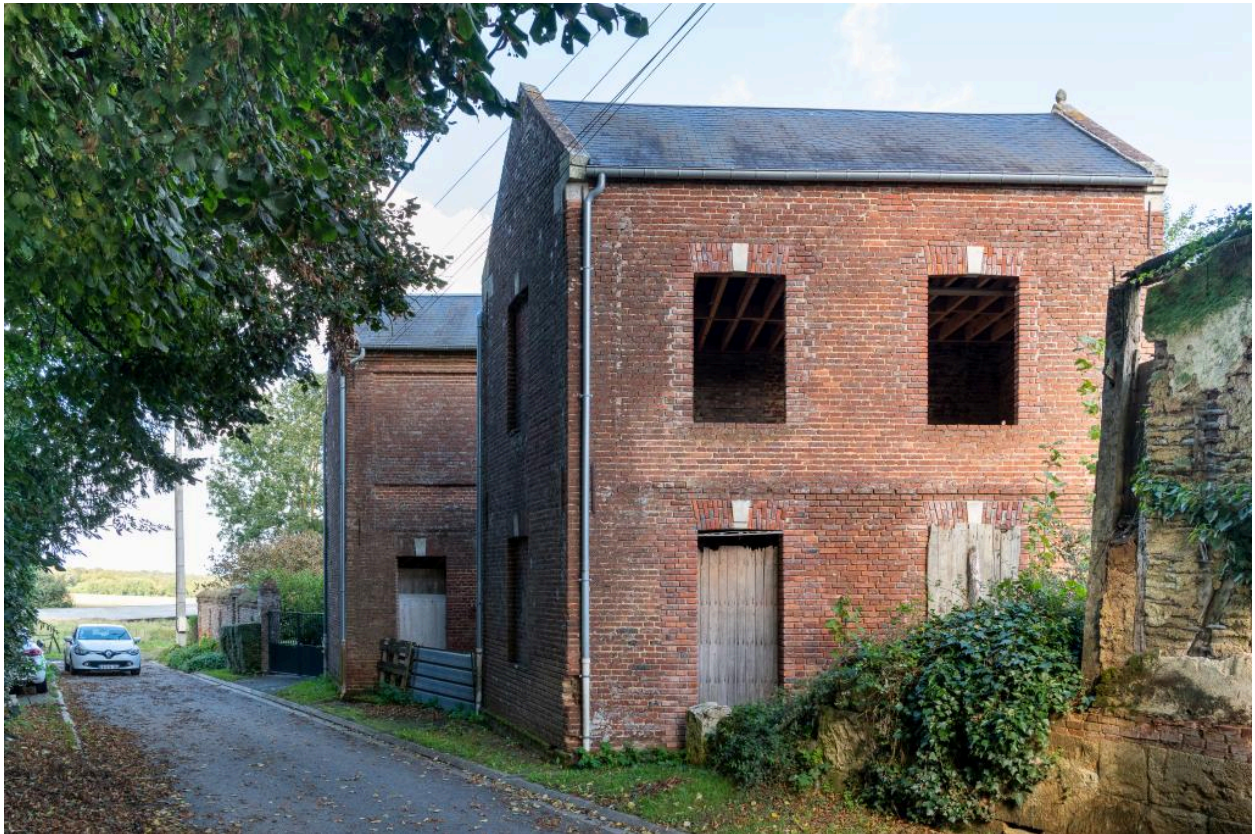
Anciens ateliers ou entrepôts de stockage d'un commerce, rue Fiscale, vue depuis le sud-ouest.
