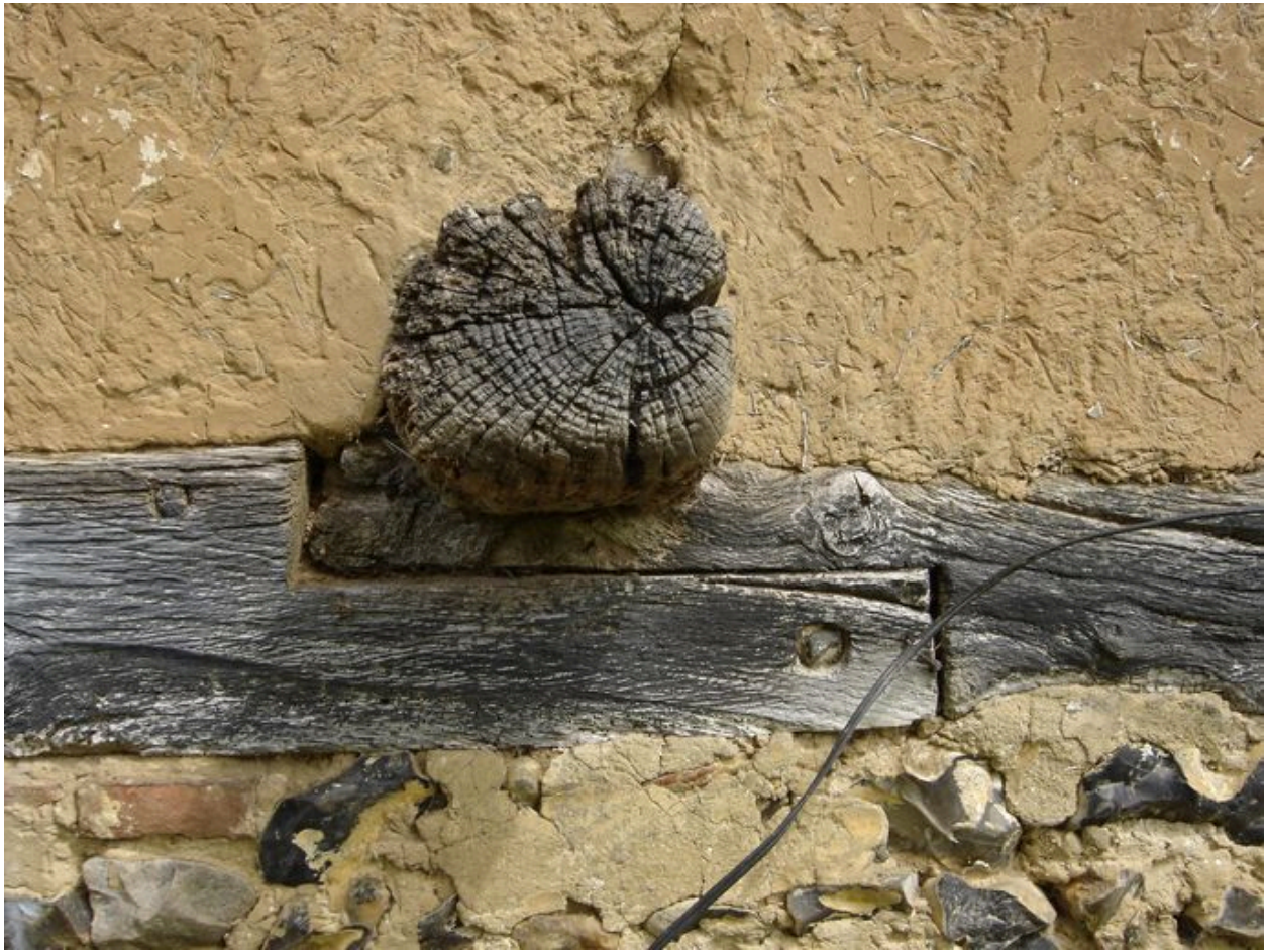
Vue détaillée de la sablière basse de la grange assemblée à mi-bois.
