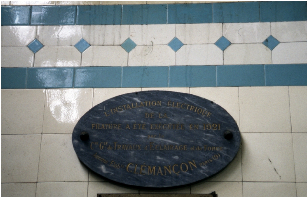
Détail de la plaque du constructeur Clémançon de l'appareillage de distribution électrique, installé dans la filature en 1921.
