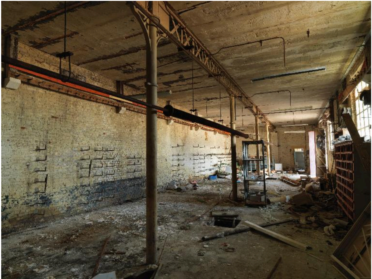
Intérieur de l'atelier des pièces détachées.
