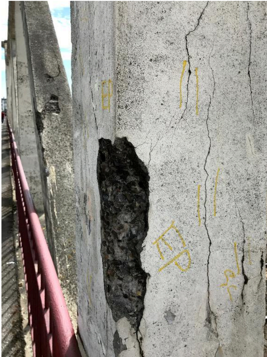
Epaufure du béton sur l'un des supports verticaux de la passerelle.
