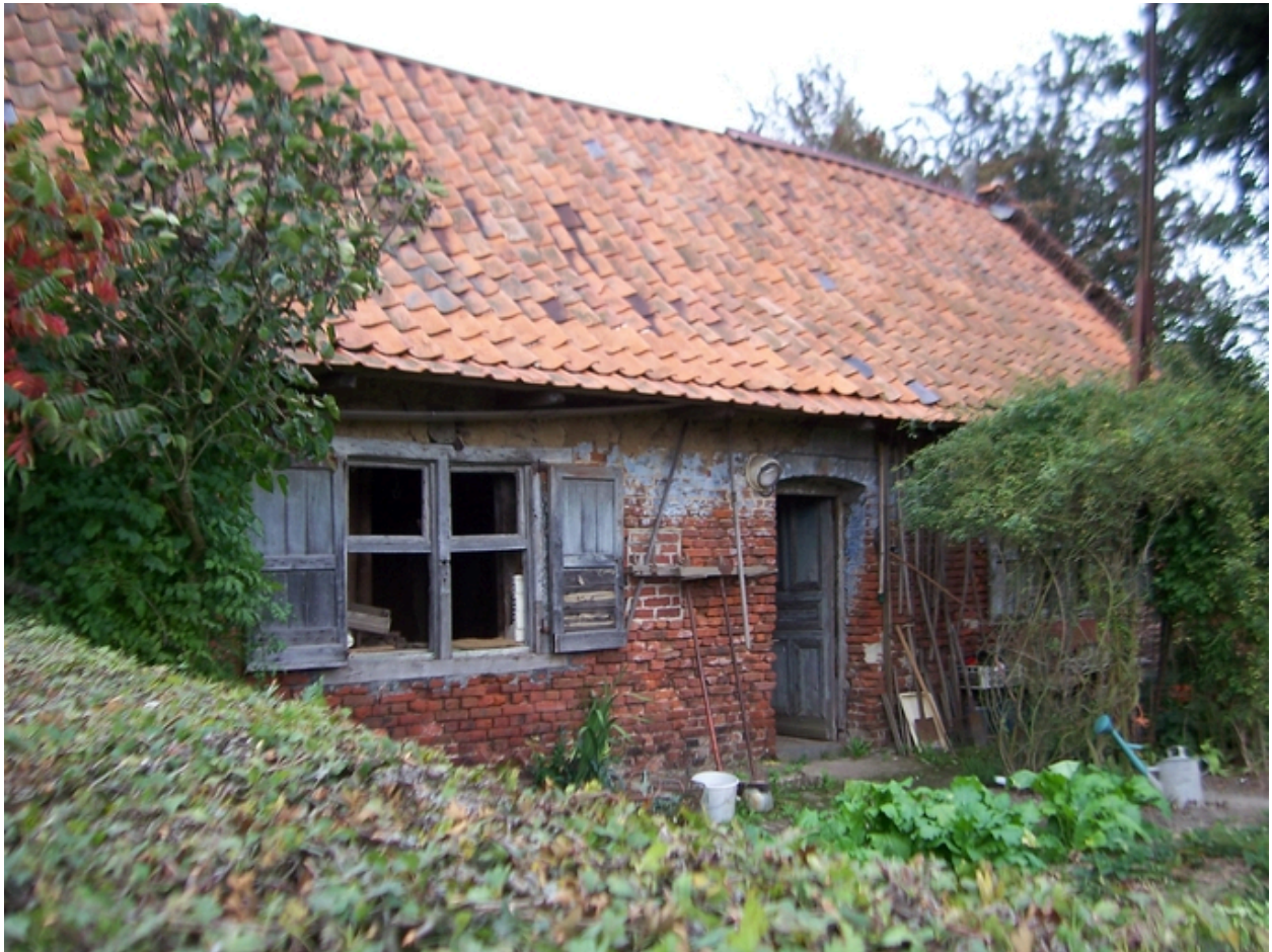
289, rue de la Pulmez : façade sur jardin, détail du logis (à l'abandon).
