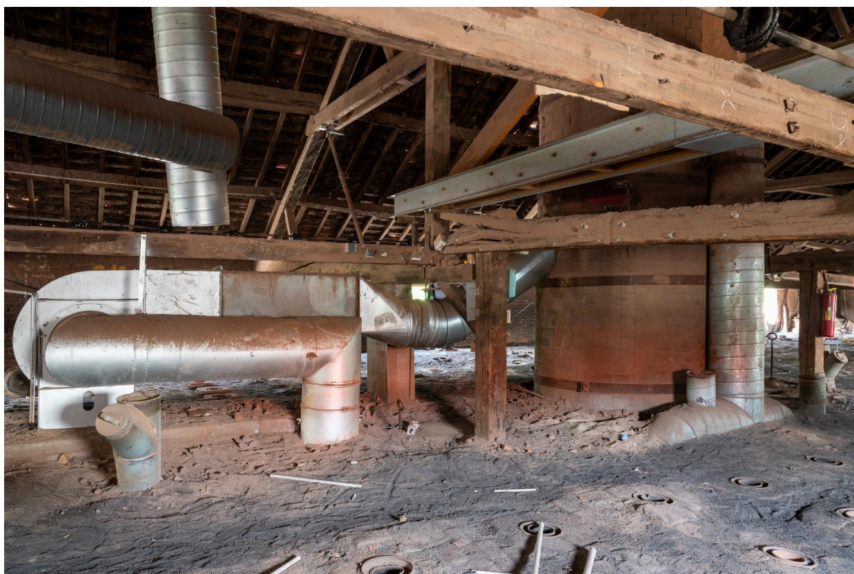
Couvrement du four Hoffmann. Cheminée d'évacuation des fumées et conduits de récupération d'air chaud pour le séchoir (étuve).
