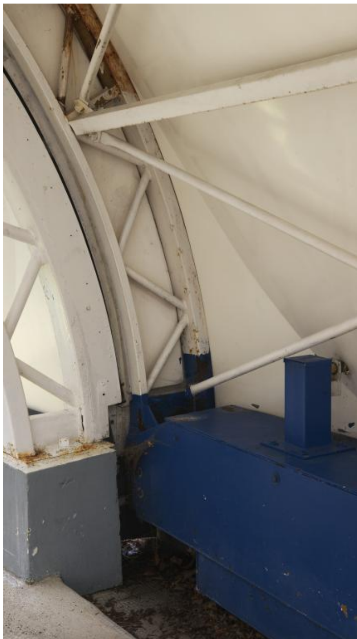
Vue intérieure de détail du mécanisme permettant le déplacement de la partie mobile.
