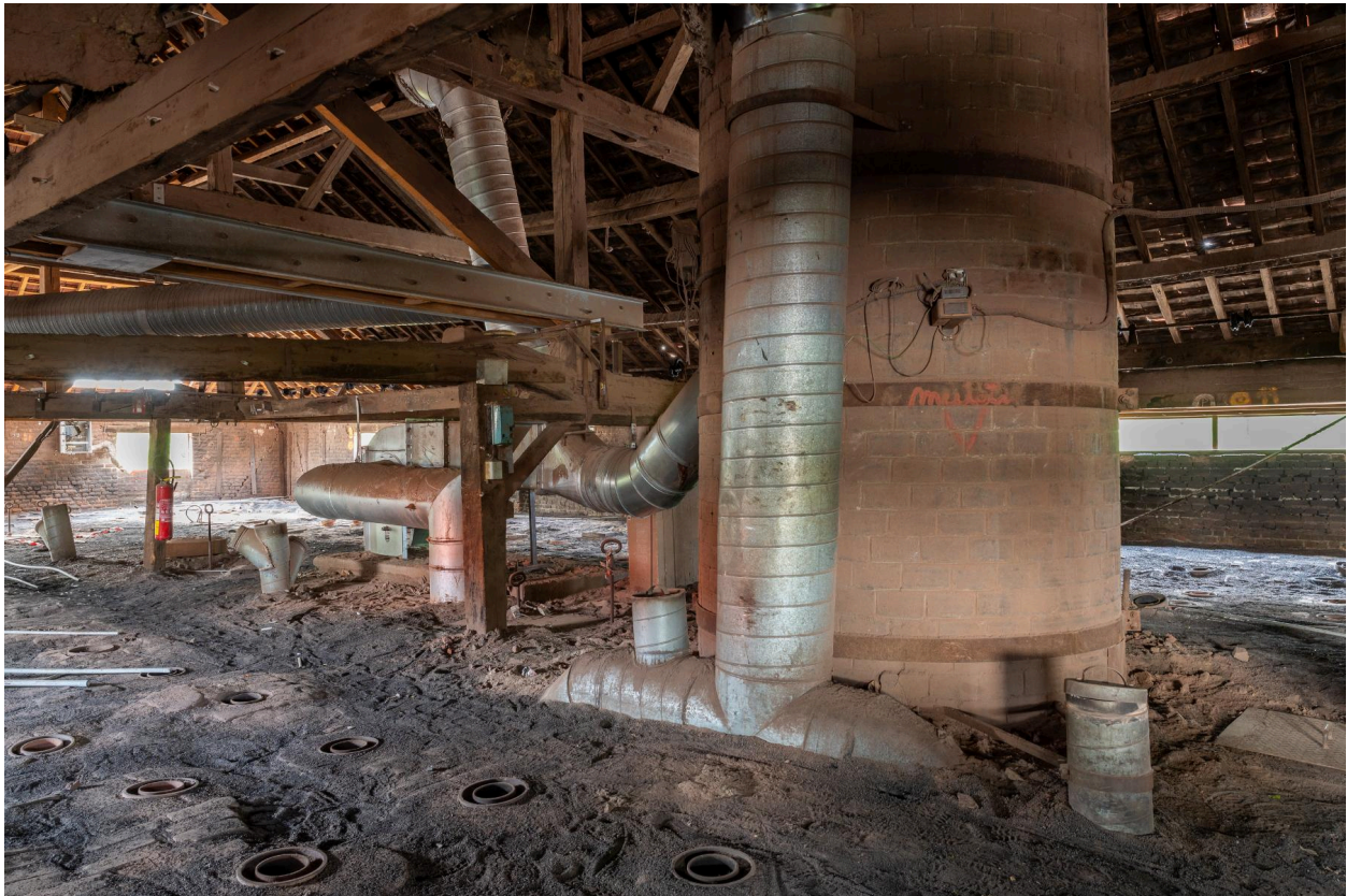
Couvrement du four Hoffmann. Cheminée d'évacuation des fumées et conduits de récupération d'air chaud pour le séchoir (étuve).
