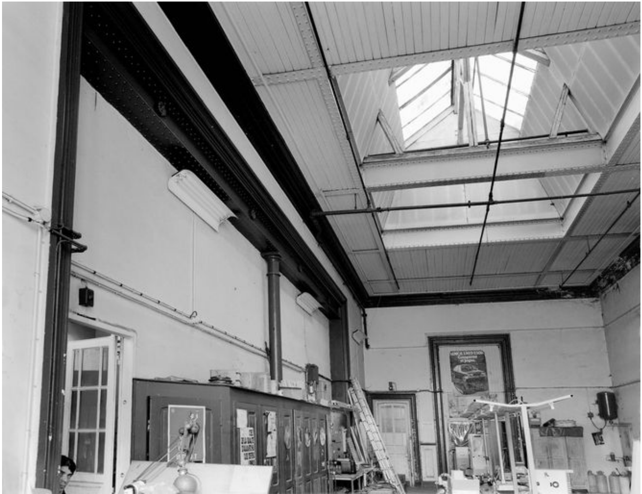
Vue intérieure de l'ancienne salle des machines. Etat en 1988.
