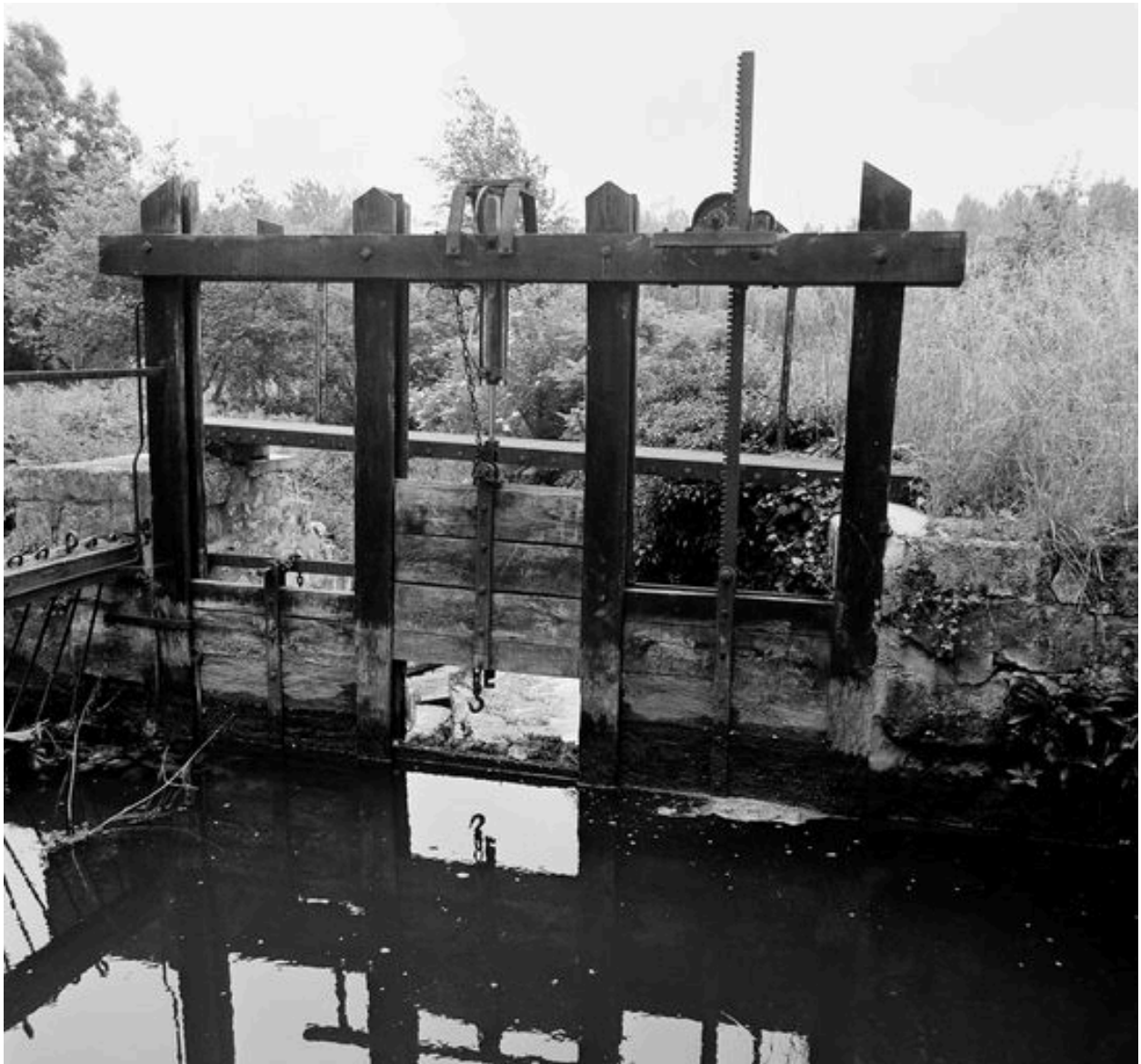
Vannes de décharge.
