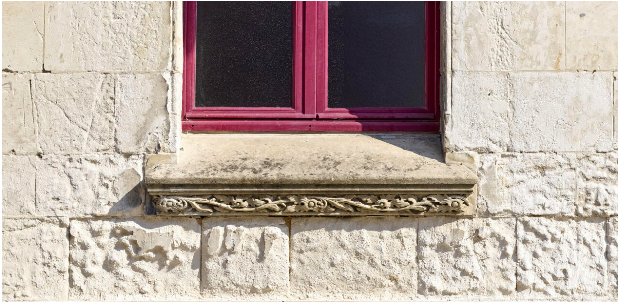
Détail du décor végétal néo-gothique de l'appui de fenêtre de la façade ouest du beffroi.
