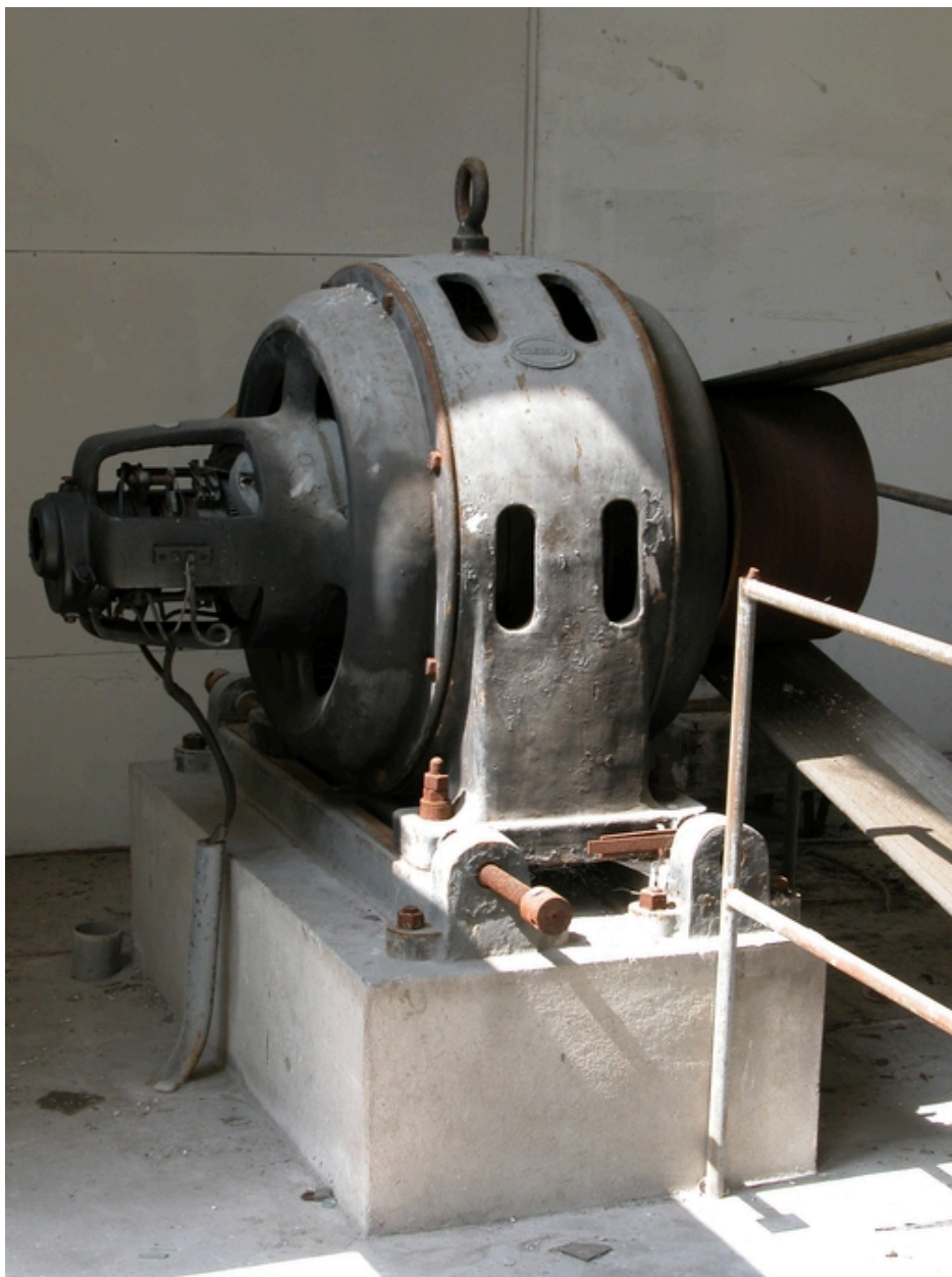
Générateur composé d'une dynamo et d'un alternateur du constructeur Schneider & Cie.
