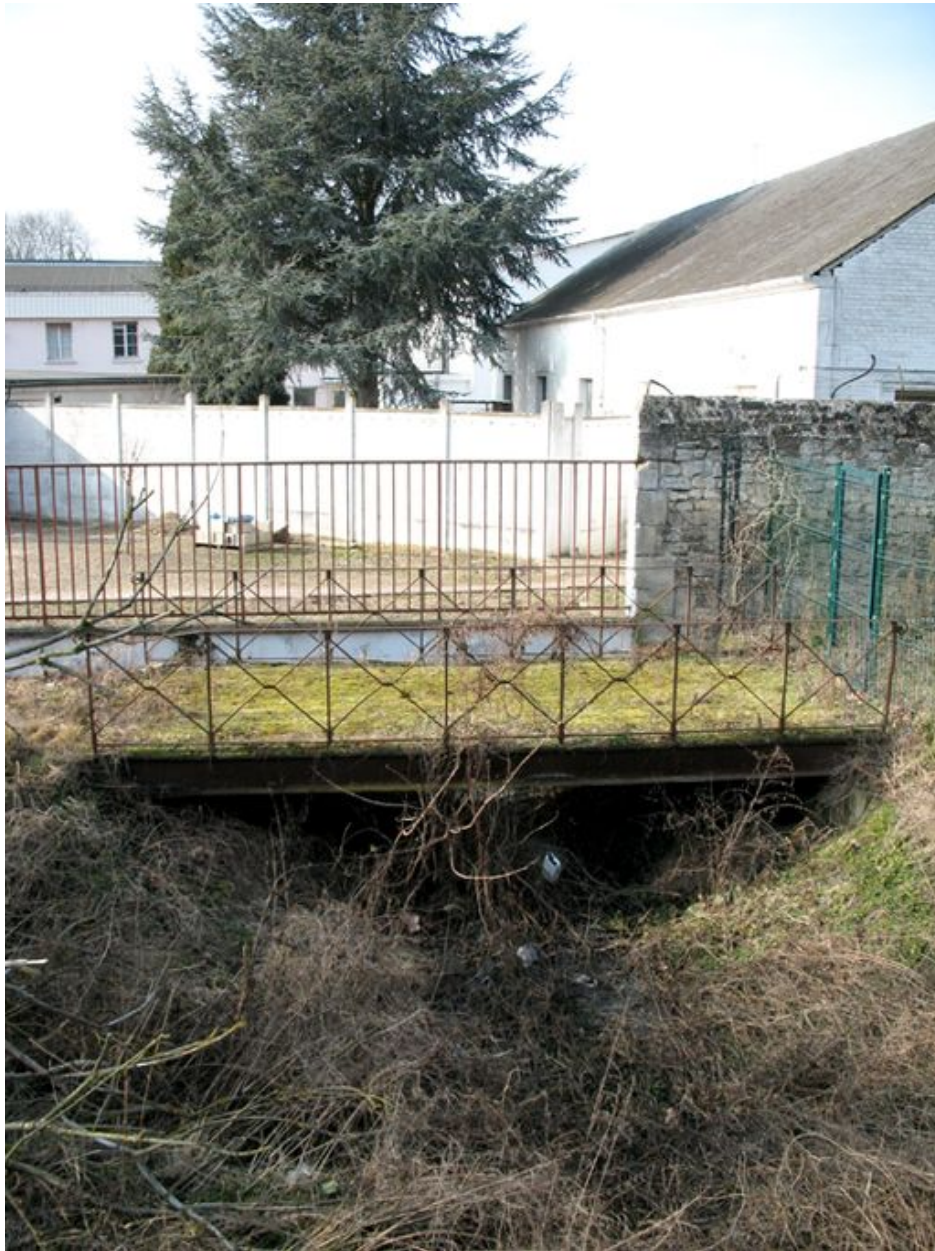
Pont sur la Brèche à l'entrée de l'usine, témoin du passage de la rivière au coeur du site.
