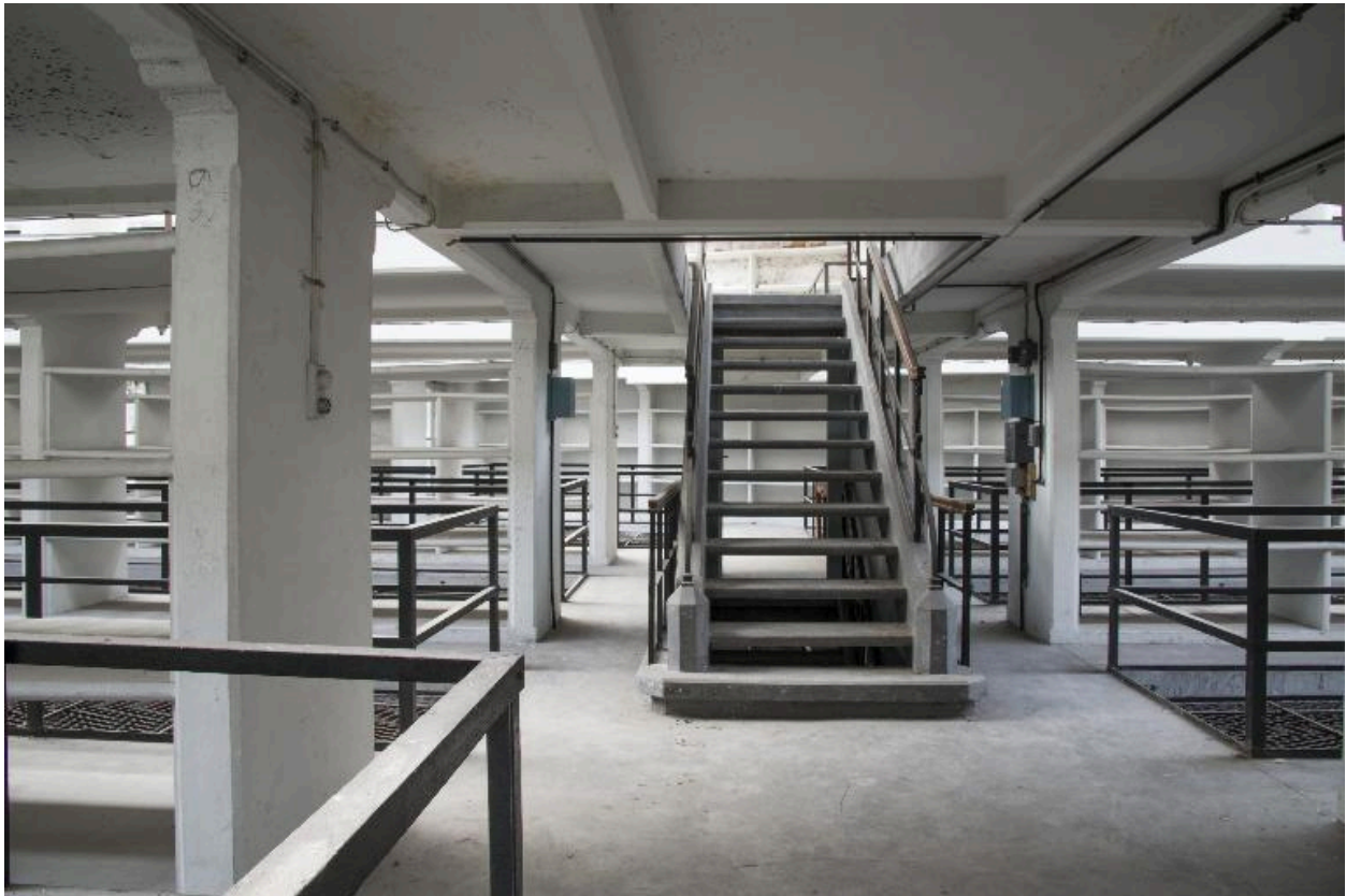
Bâtiment du dépôt, deuxième étage : vue du palier et départ de l'escalier.
