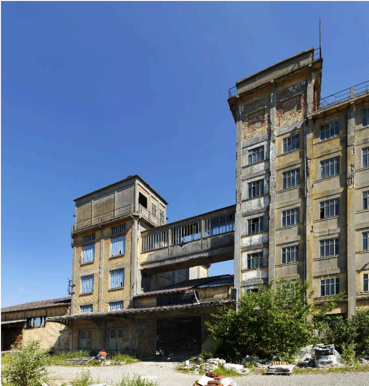
Vue partielle de la façade sud de la minoterie et de la passerelle couverte.
