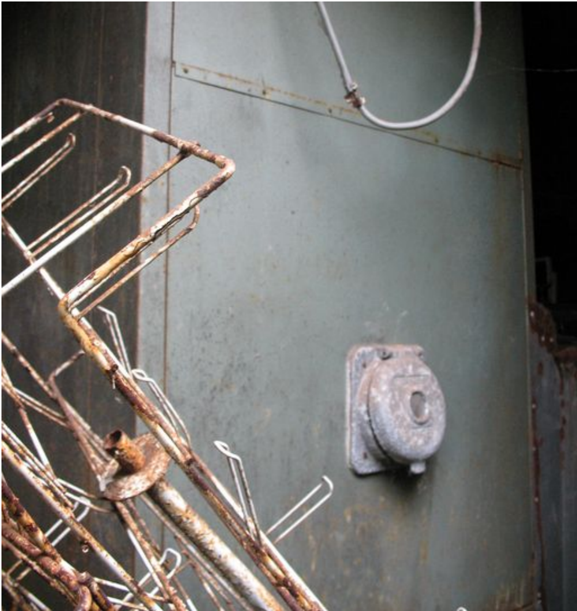
Le générateur électrique.
