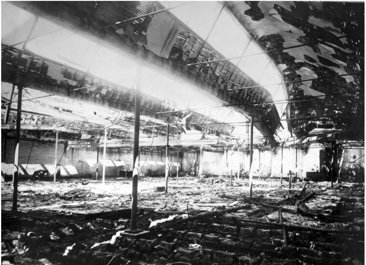
Vue intérieure des ateliers après les destructions de la Première Guerre mondiale (AD Aisne).
