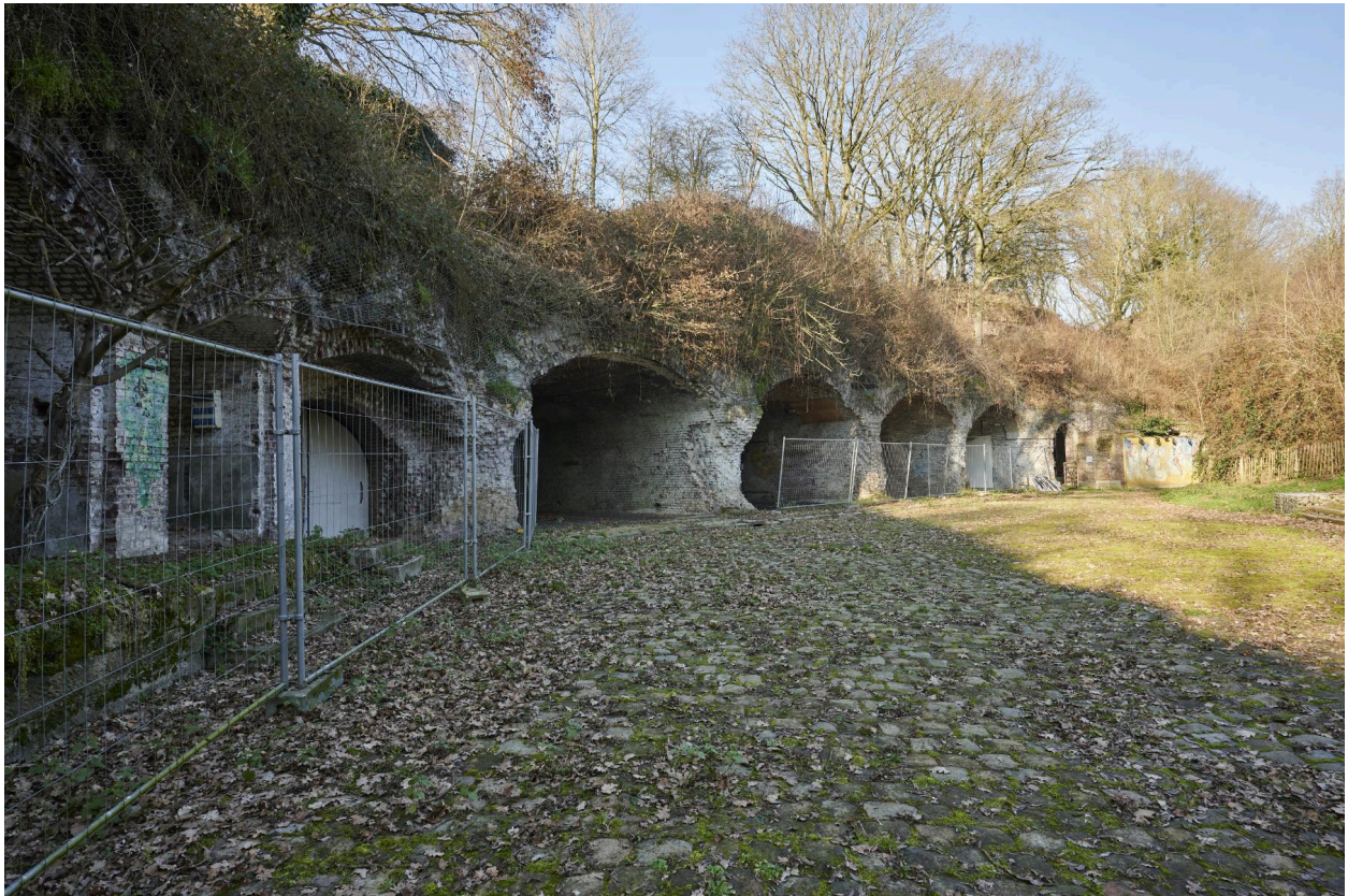
Aile ouest. Casernes effondrées de la crête d'artillerie.
