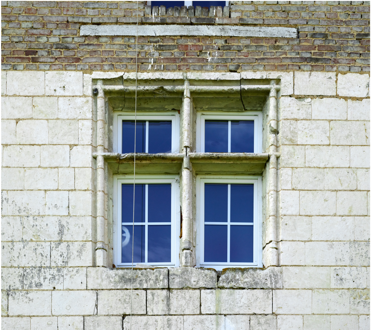
Détail de la fenêtre à meneau de la façade nord du manoir.
