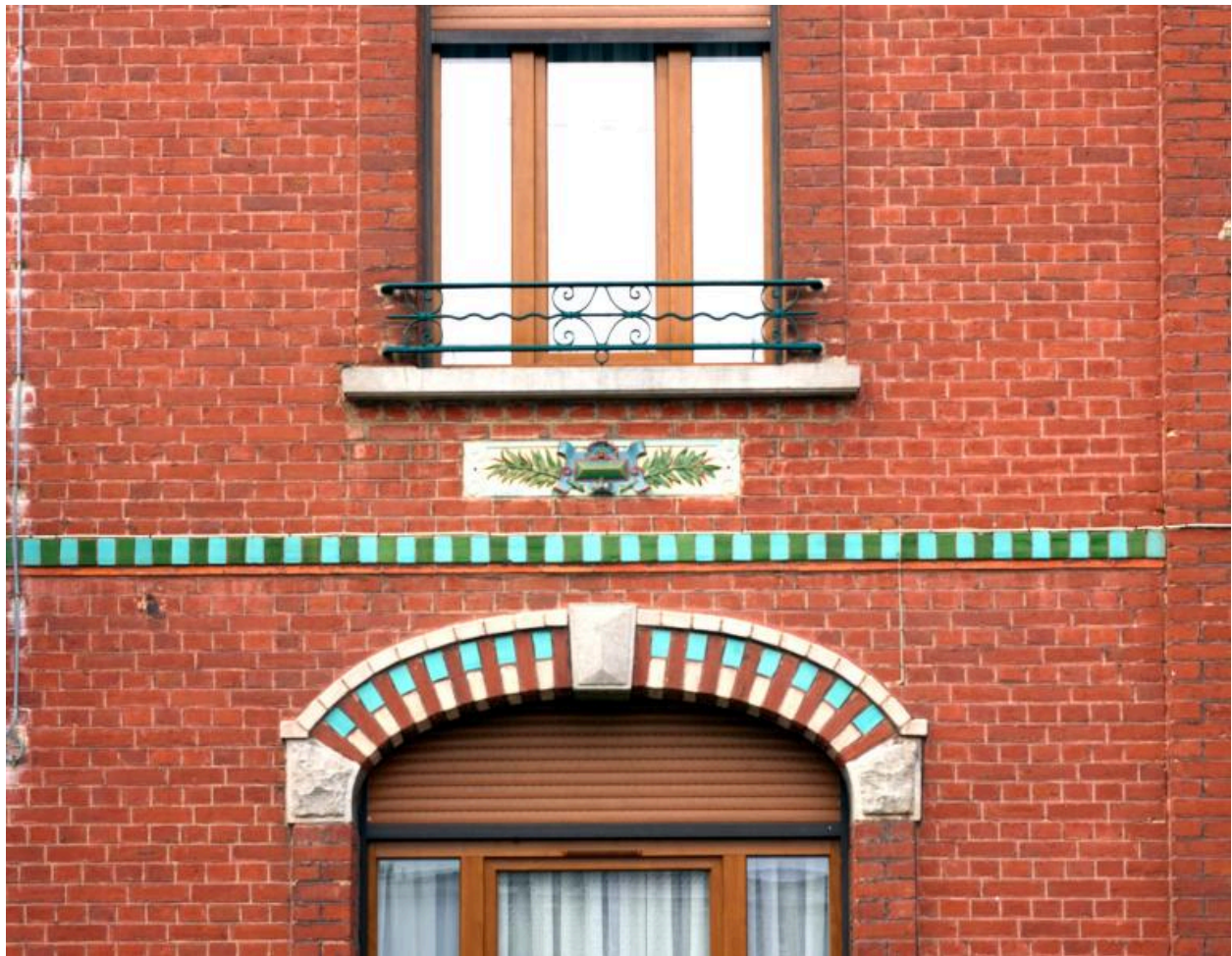
Maison n°8 rue Lecointe. Détail du décor de briques et du panneau décoratif émaillés.
