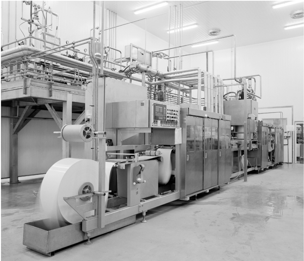
Conditionnement de la compote de pommes : vue d'ensemble de la ligne de thermoformage.
