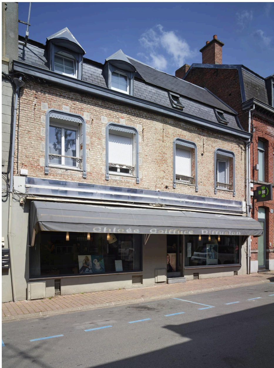
Maison à boutique - 8, rue Gambetta : exemple de bâti XVIIIe siècle sur lequel est venu se greffer une vitrine en applique du XXe siècle.
