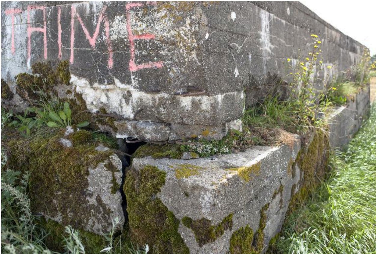
Angle nord-est. Effet du dynamitage de l'abris
